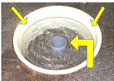
写真3 処理室内に埋め込まれた洗浄槽
