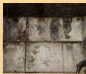
劣化したコンクリート
