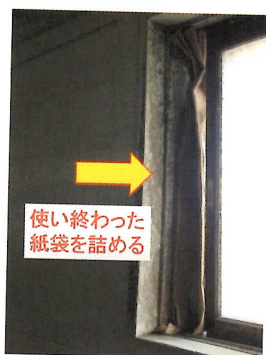
写真2 風雪の強い日は使い終わった紙袋を再利用(窓の隙間に詰める)
